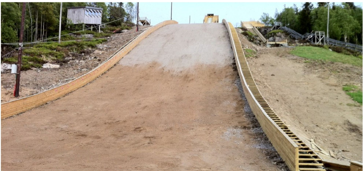
Etter at grunnarbeidet var gjort på nytt var bakken klar til plastlegging i juni 2011
